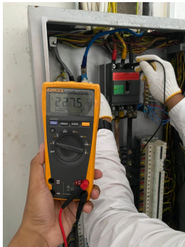
Gambar 7. Pengukuran Tegangan listrik
