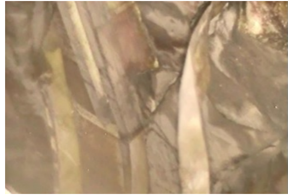
Gambar 17 . Isolasi rusak/tidak normal.
