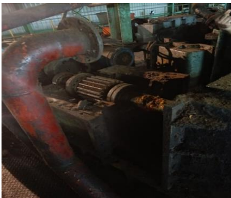
Gambar 3. Perawatan Pada Spur Gearbox Sumber: PT Kayung Agro Lestari
