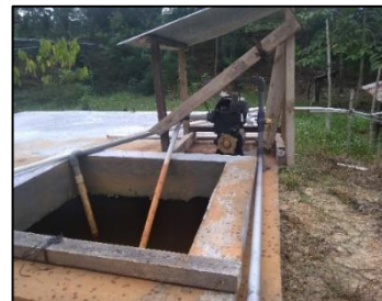
Gambar 3. Bak penampung air
