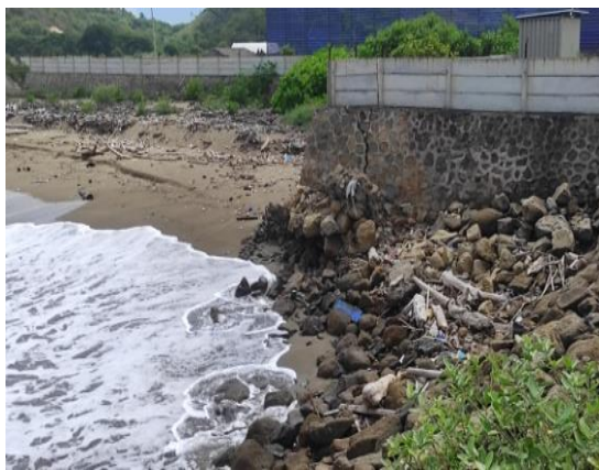
Gambar 1. Kondisi Bangunan Pembatas ULPLTU
