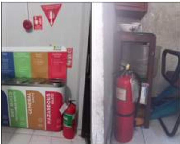
Gambar 3. Peletakan APAR di Lantai
