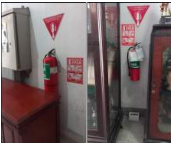
Gambar 4. Peletakan APAR Tertutup Benda
