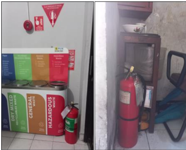
Gambar 3. Peletakan APAR di Lantai
