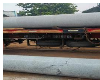
Gambar 2 Contoh defect di lapangan (Material spunpile mengalami retak karena terjatuh dari truk)
