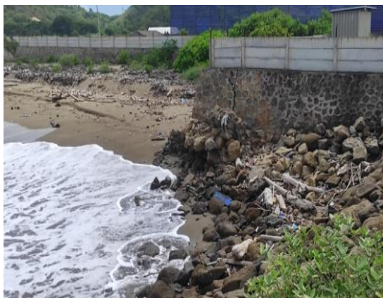
Gambar 1. Kondisi Bangunan Pembatas ULPLTU
